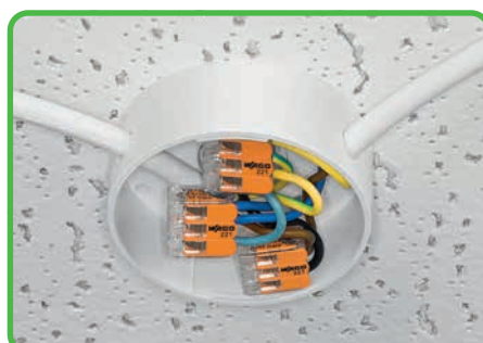
Puszka rozdzielcza do zasilania oświetlenia sufitowego
